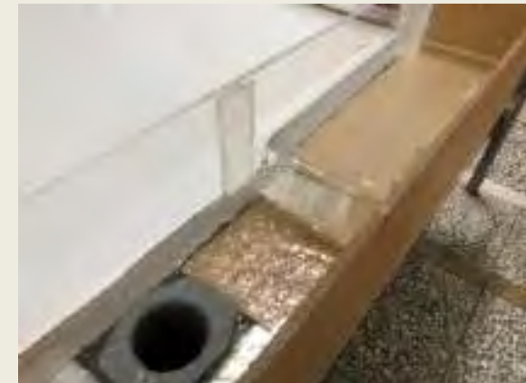
尾水堰板控制水深
