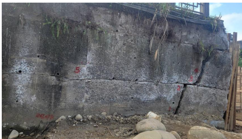
頭寮步道裂縫情形
