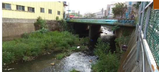
大坑缺橋現況
