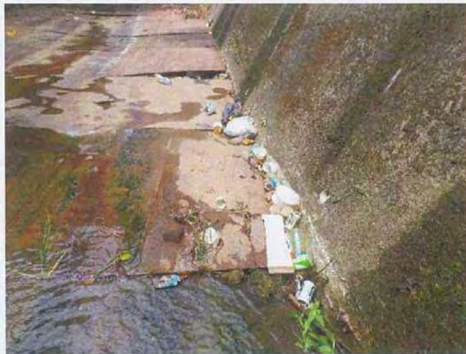
3. 鄰近匯流口施工便道鋪設之鋼板上時常可見民生廢棄物堆積，建議定期派員清除，降低流入南崁溪主流之廢棄物量。
