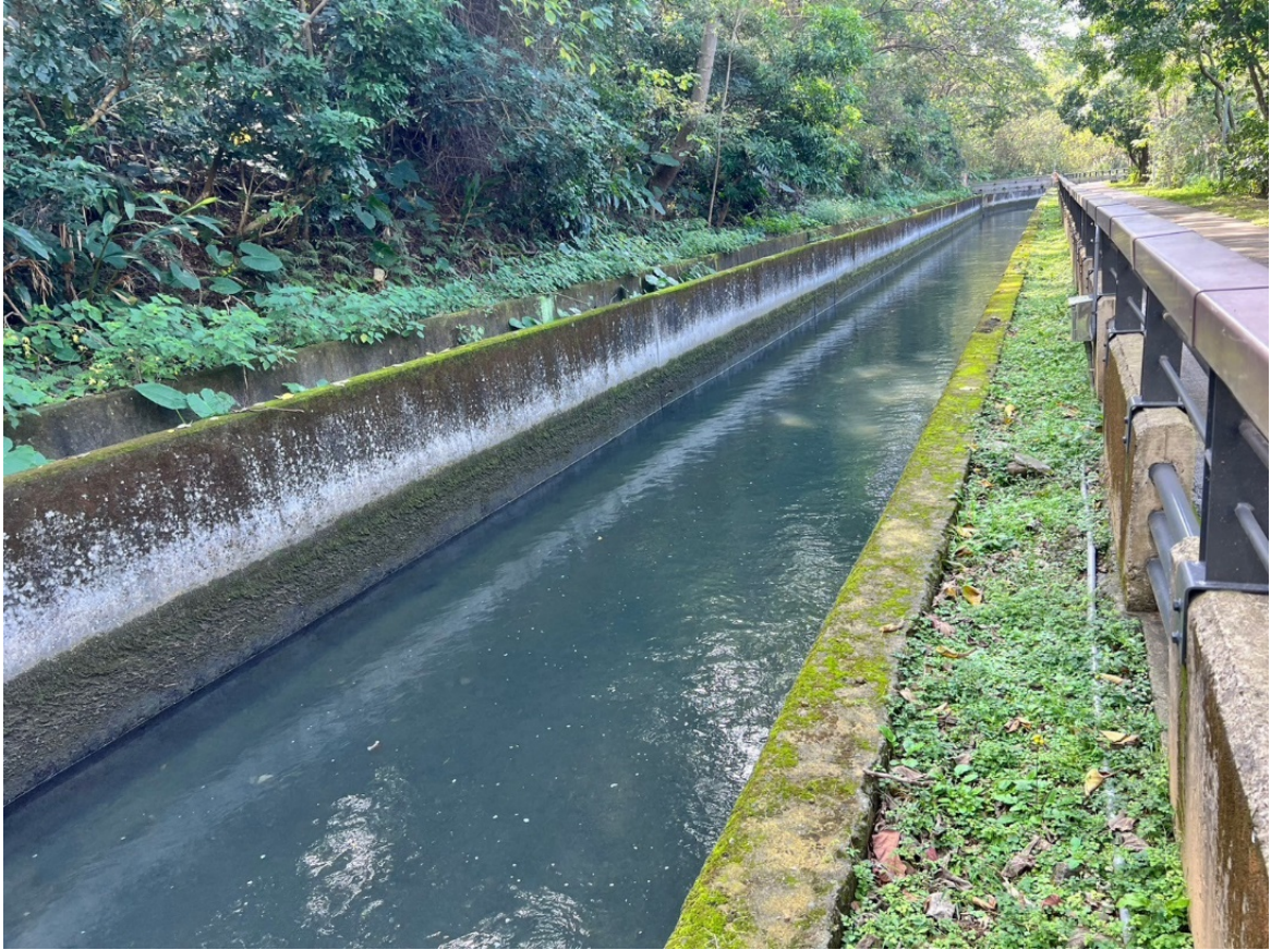
建議渠道設置安全防墜網
