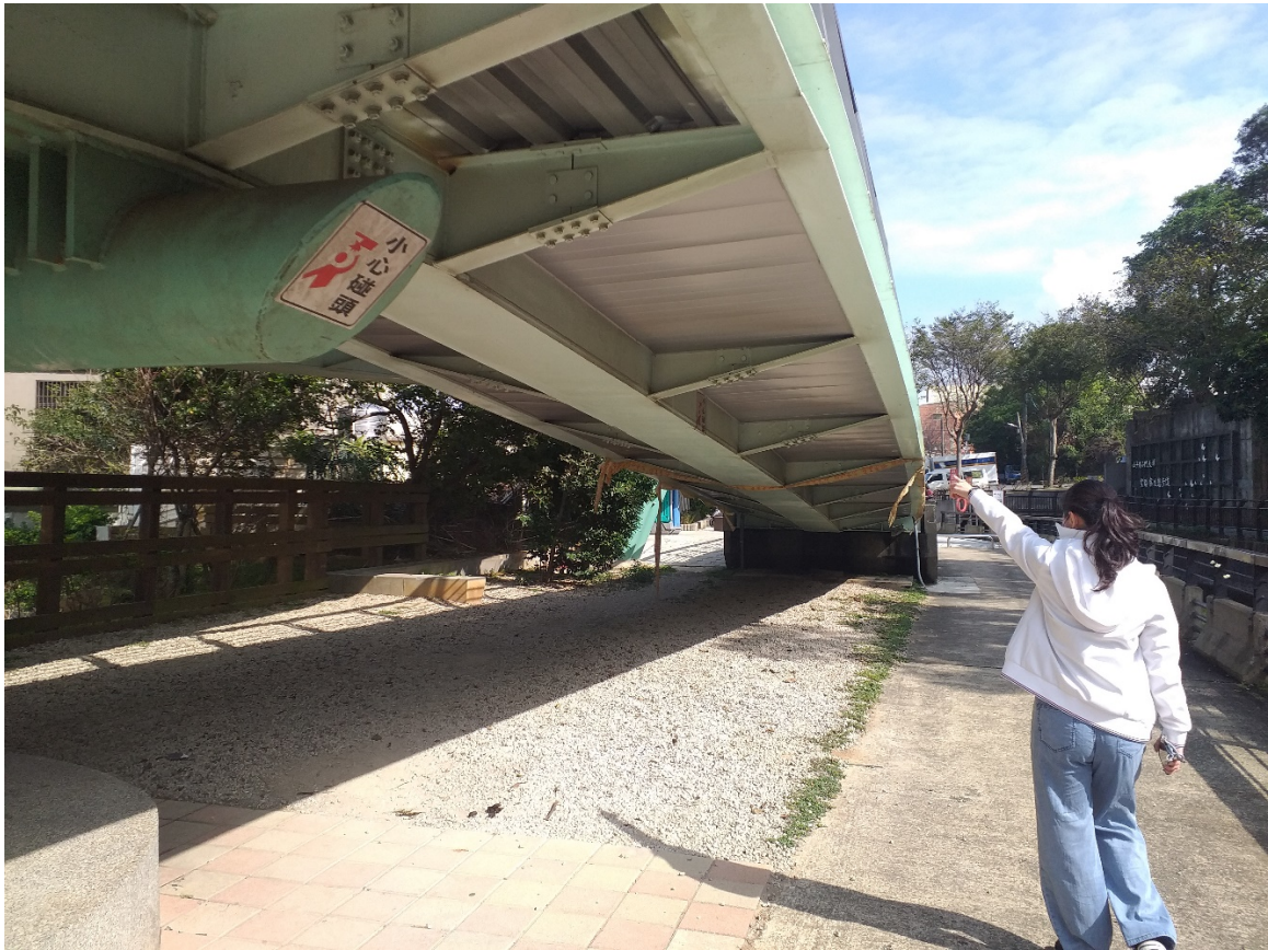
橋下建議設置防撞墊或圍欄
