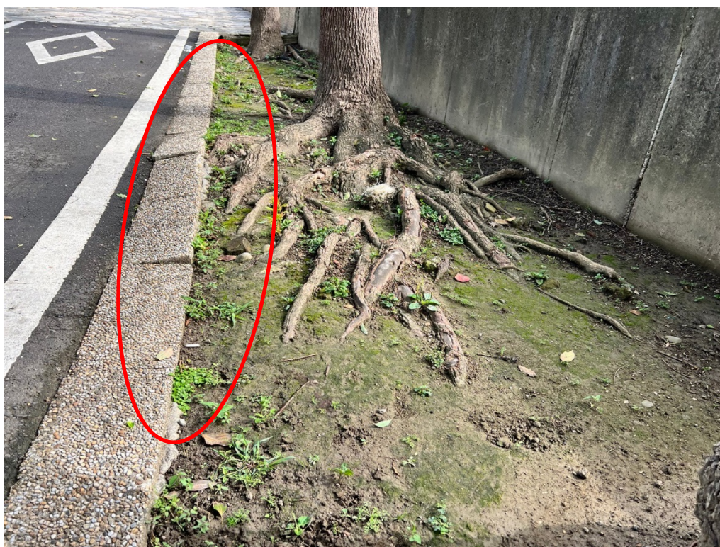
大樹樹根擠壓導致路面邊緣破損、隆起
