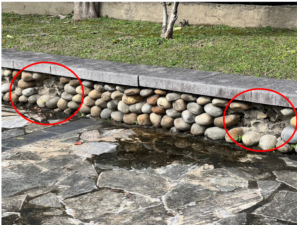
砌石掉落需修補
